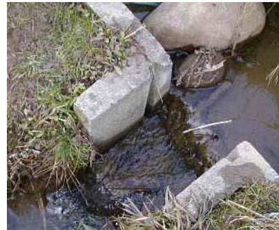
水路との接続部に生じた隙間 (角落しが入らない)
