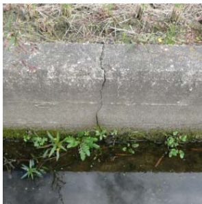
縦方向のひび割れ
