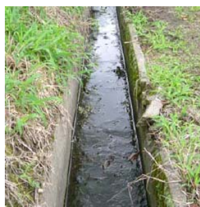
部分的な欠損
