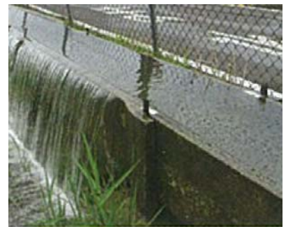
水路からの溢水
