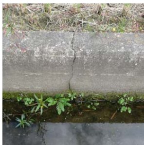
縦方向のひび割れ
