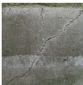
斜め方向のひび割れ
