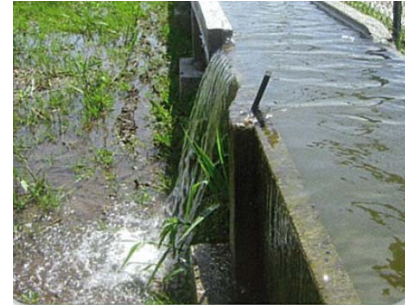
水路からの部分的な溢水
