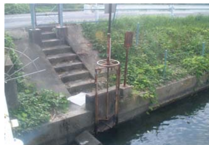
老朽化したゲート
