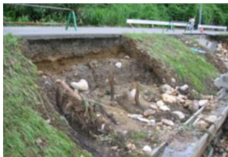
道路法面の崩壊状況
