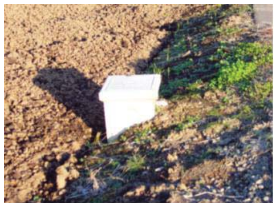
傾いた給水栓ボックス
