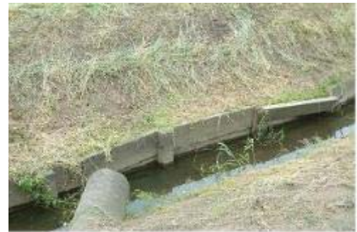
水路側壁のはらみの状況
