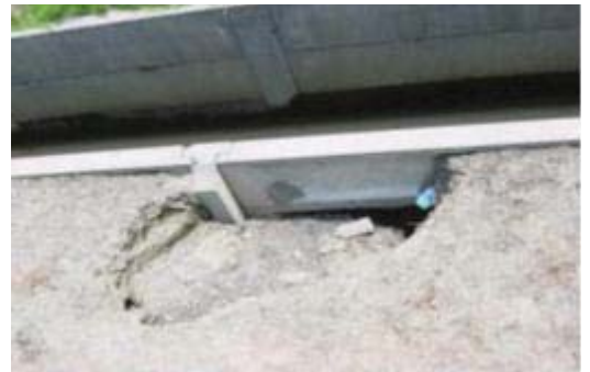
水路側壁の空洞状況
