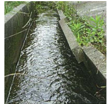
側壁の倒壊（側溝）
