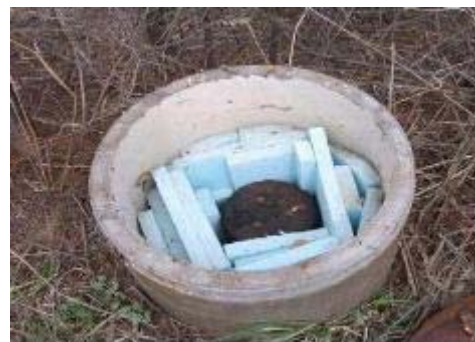
給水栓ボックス内の保温状況
