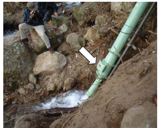
簡易な発電機 (図の矢印)
