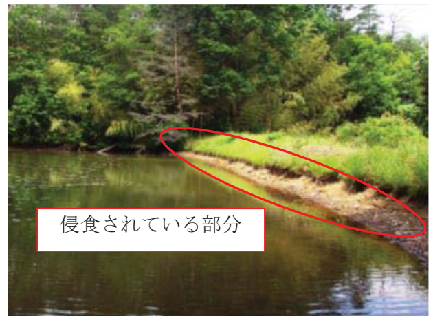
侵食が生じているため池堤体
