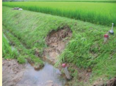
農用地法面が崩れた状況
