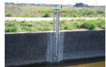
巻き上げ式ゲート（分水用ゲート）
