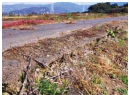
路肩の浸食と路面下の空洞
