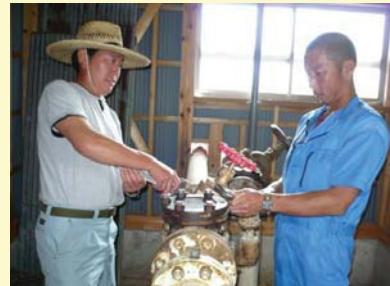
ポンプの点検状況
