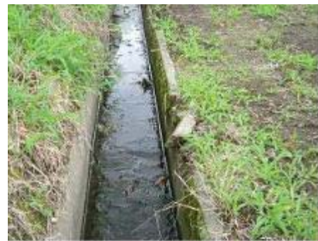
破損したU字溝
