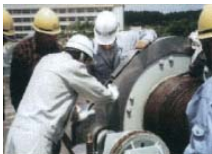
ポンプ点検状況
