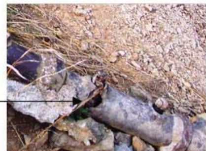
古い樋管（陶製）の破損
