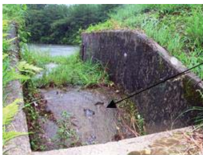
洪水吐底板（コンクリート）の欠損
