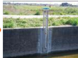
巻き上げ式ゲート
