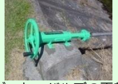
ゲート、バルブの更新
